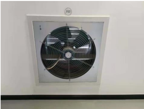
图6-5 220kV 配电装置室通风
