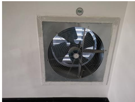
图6-4 110kV 配电装置室通风
