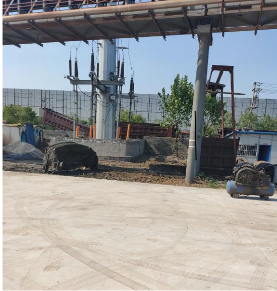
图 7-1 单回电缆线路检测点位
