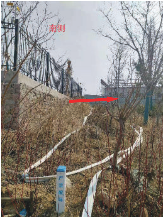
图 4-5 蓝谷 110kV 变电站西南侧
