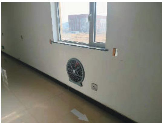
图 \zeta -6 110kV GIS 室通风
