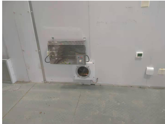
图6-4 110kV GIS 室排风扇
