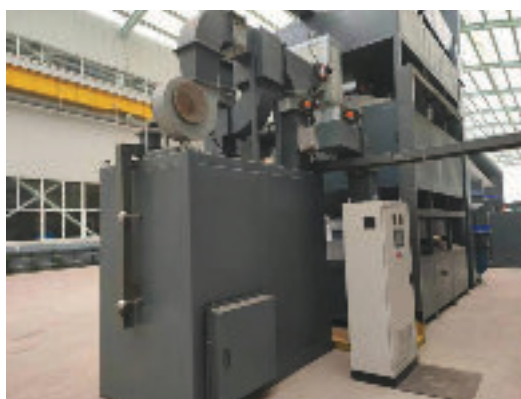
油缸车间喷漆废气处理设施
