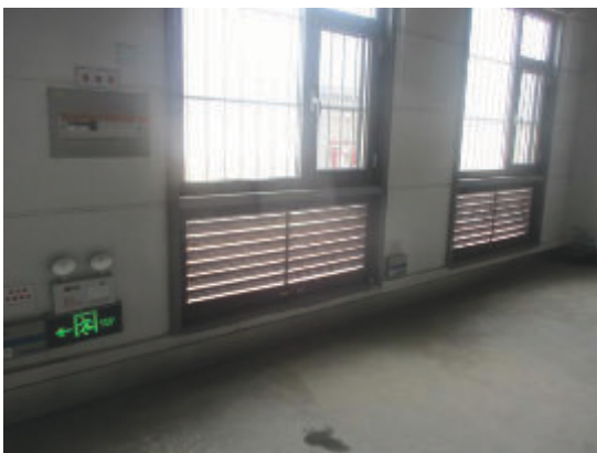
图 \zeta -5 110kV 配电室通风
