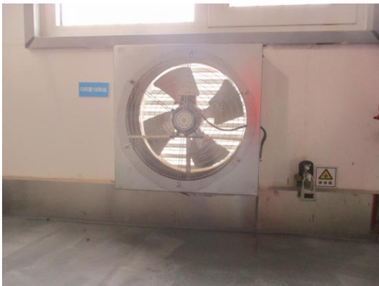
图6-5 110kV 配电室通风
