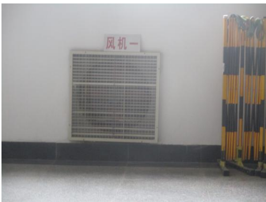
图6-5 110kV 配电室通风
