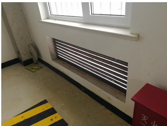
图6-5 110kV 配电室通风
