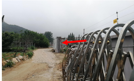
图 4-4 上庄 110kV 变电站南侧
