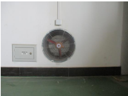
图6-5 110kV 配电室通风
