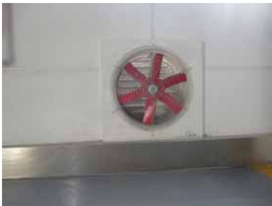
图6-5 110kV 配电室通风
