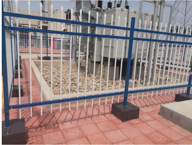
主变压器下贮油坑
