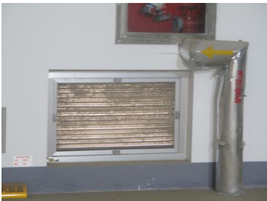
图6-5 110kV 配电室通风
