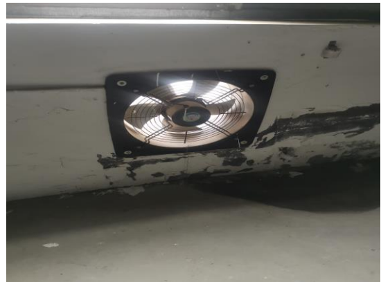
图 6-4 220kV 配电装置室通风
