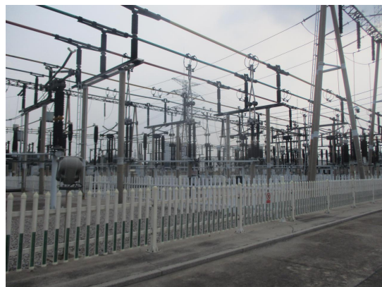
图 4-9 220kV 配电装置
