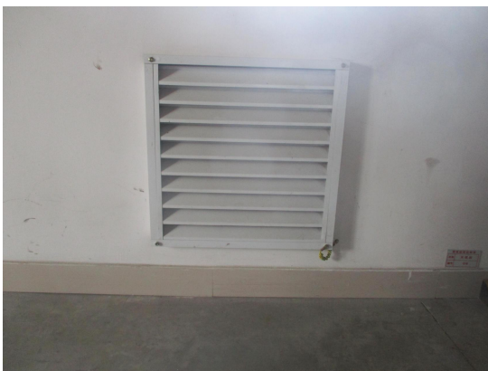
图6-5 110kV 配电室通风
