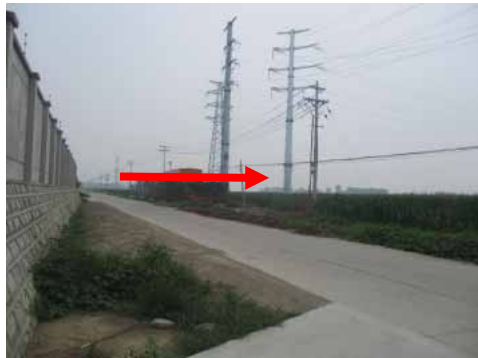
图 4-5 苑城 110kV 变电站西侧
