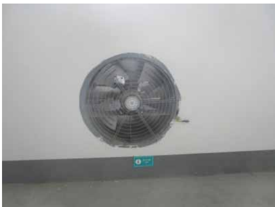
图6-5 110kV 配电室通风
