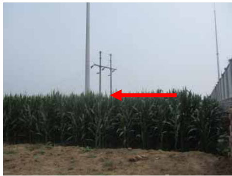
图 4-3 苑城 110kV 变电站东侧
