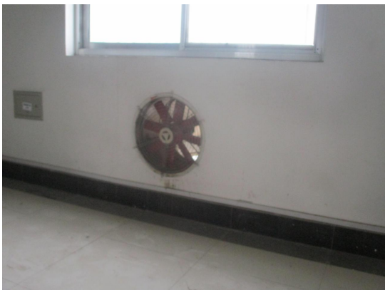
图6-5 220kV 配电室通风
