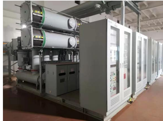
图 4-8 220kV 配电装置
