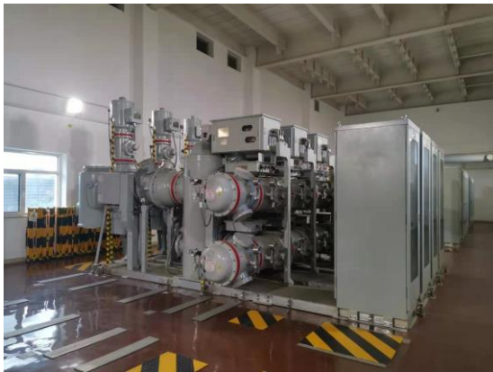
图 4-9 110kV 配电装置
