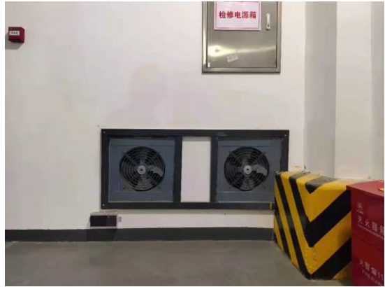
图6-4 110kV 配电装置室通风
