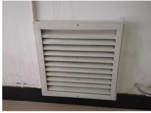
图6-4 110kV 配电装置室通风
