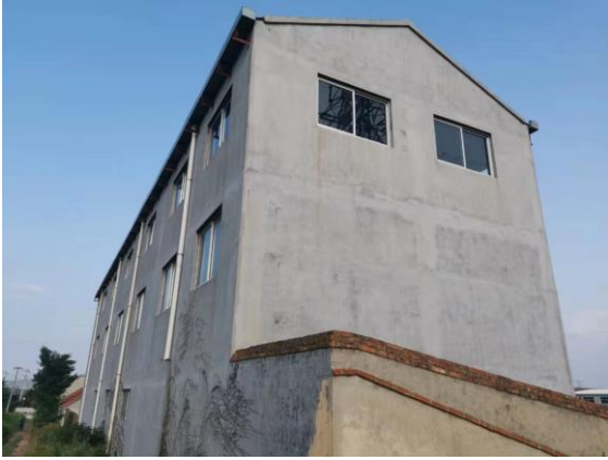
图2-1 110kV车金线2#-3#线东15m厂房
