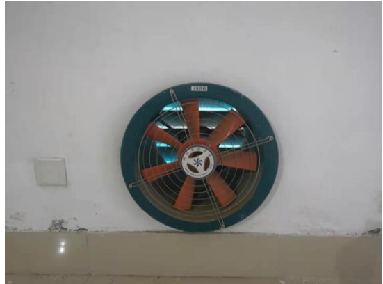
图6-4 110kV 配电装置室通风
