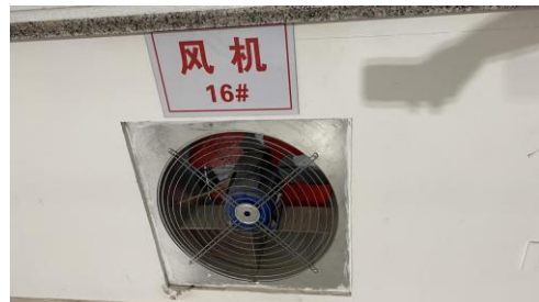
图6-6 110kV GIS 室排风扇
