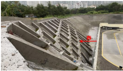
图 4-5 江山南 110kV 变电站西侧
