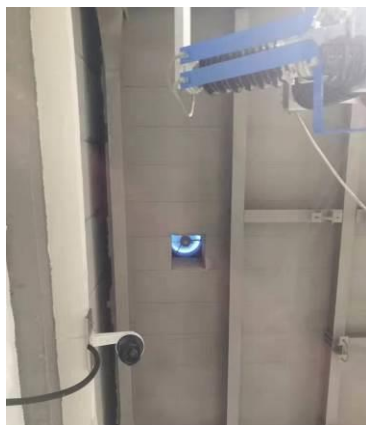
图6-5 110kV 配电室通风
