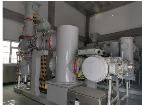
图 4-10 110kV 配电装置
