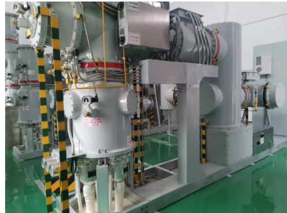
图 4-10 110kV 配电装置
