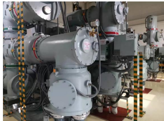
图 4-10 110kV 配电装置
