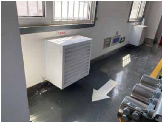
图6-5 110kV 配电室通风
