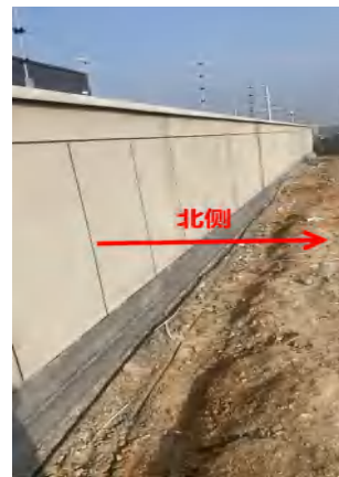
图 4-6 星火 220kV 变电站北侧
