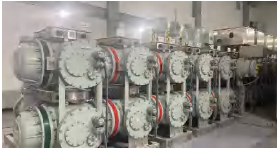
图 4-9 220kV 配电装置
