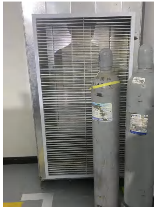
图6-6 220kV GIS 室通风口
