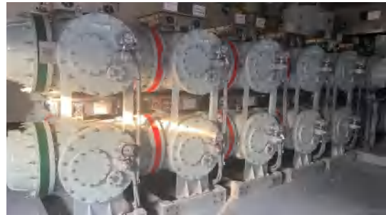
图 4-10 110kV 配电装置
