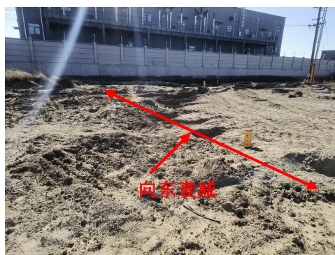
图 7-4 110kV 江新线/110kV 江新 II 线双回电缆线路处
