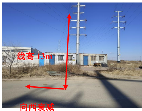
图 7-1 110kV 江盐线 1#~2#/110kV 江香线 1#~2#双回架空线路处
