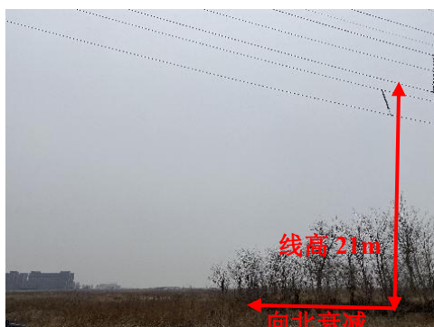
图 7-3 110kV 江新线 8#~9#/110kV 江新 II 线 8#~9#双回架空线路处
