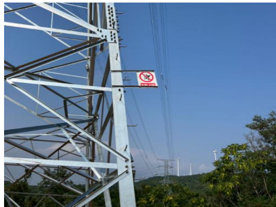
图 6-8 杆塔安全警告与防护标志
